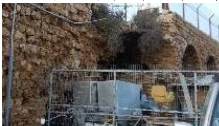
איור 13- התמוטטות חלק מהקמרון העליון
