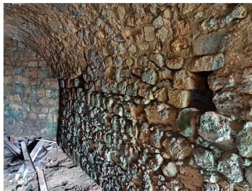
איור 20- חוסר מליטה עמוקה מאוד במישקים
